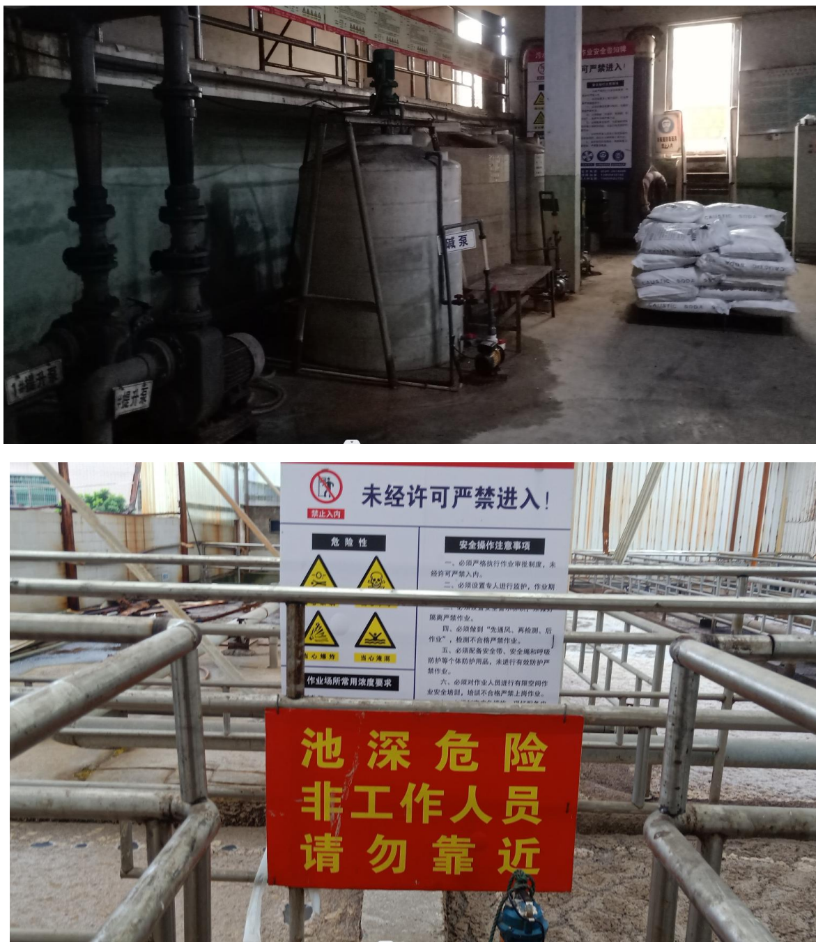
图 3.1-1 项目废水处理设施
