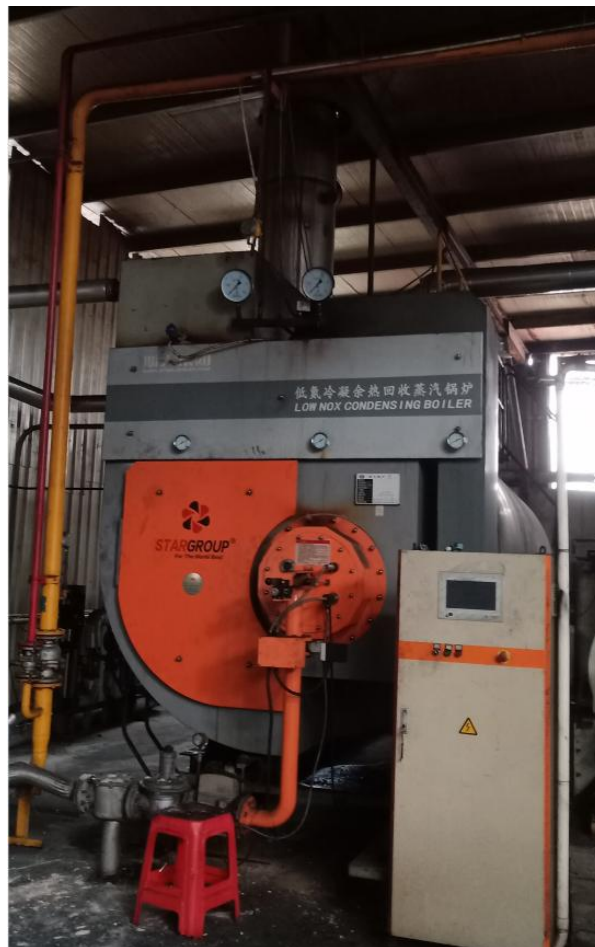
图 3.2-1 天然气锅炉通过一根 20m 高烟囱排放
