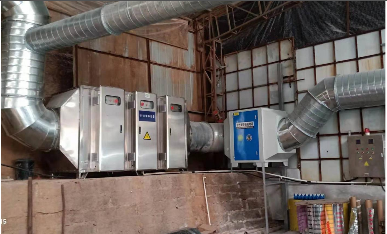
UV 光解净化装置+活性炭吸附装置+15m 高排气筒
