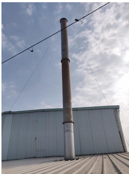
图 3-2 燃气锅炉烟囱
