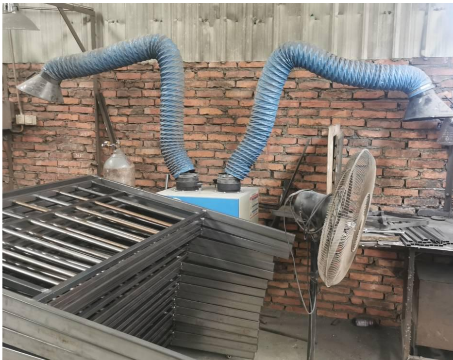
移动式除尘设施
